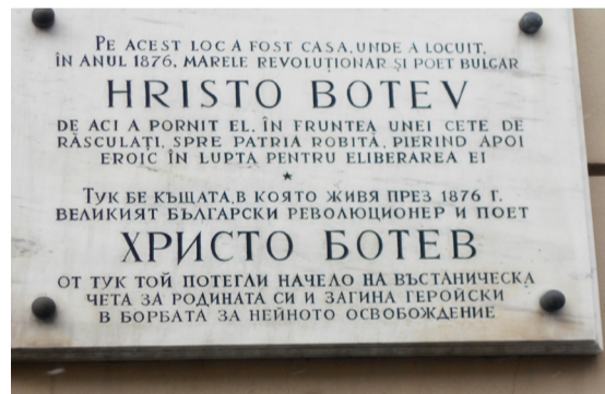
Паметни плочи в Букурещ, които в най-скоро време трябва да се отремонтират и запазят, защото са поставени на стените на жилищни сгради, които скоро ще рухнат. Фото: Георги ЙОВЧЕВ
